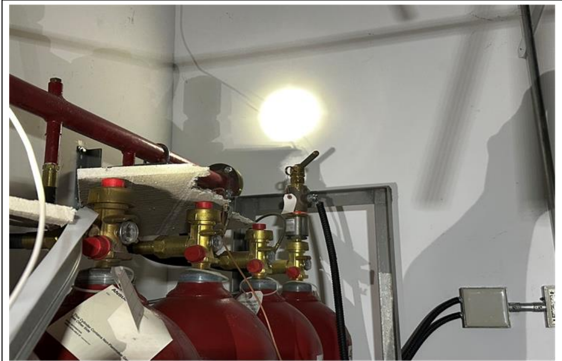
惰性氣體滅火設備誤動作區域(疑似造成事故發生原因)
