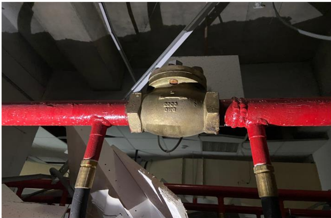
惰性氣體滅火設備選擇閥
