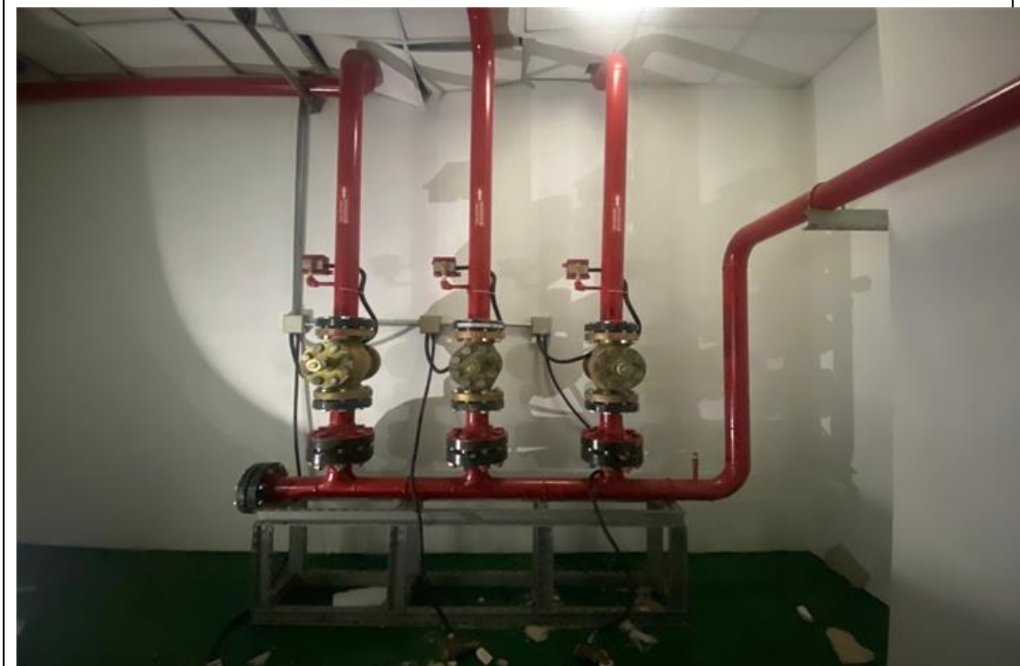
惰性氣體滅火設備選擇閥
