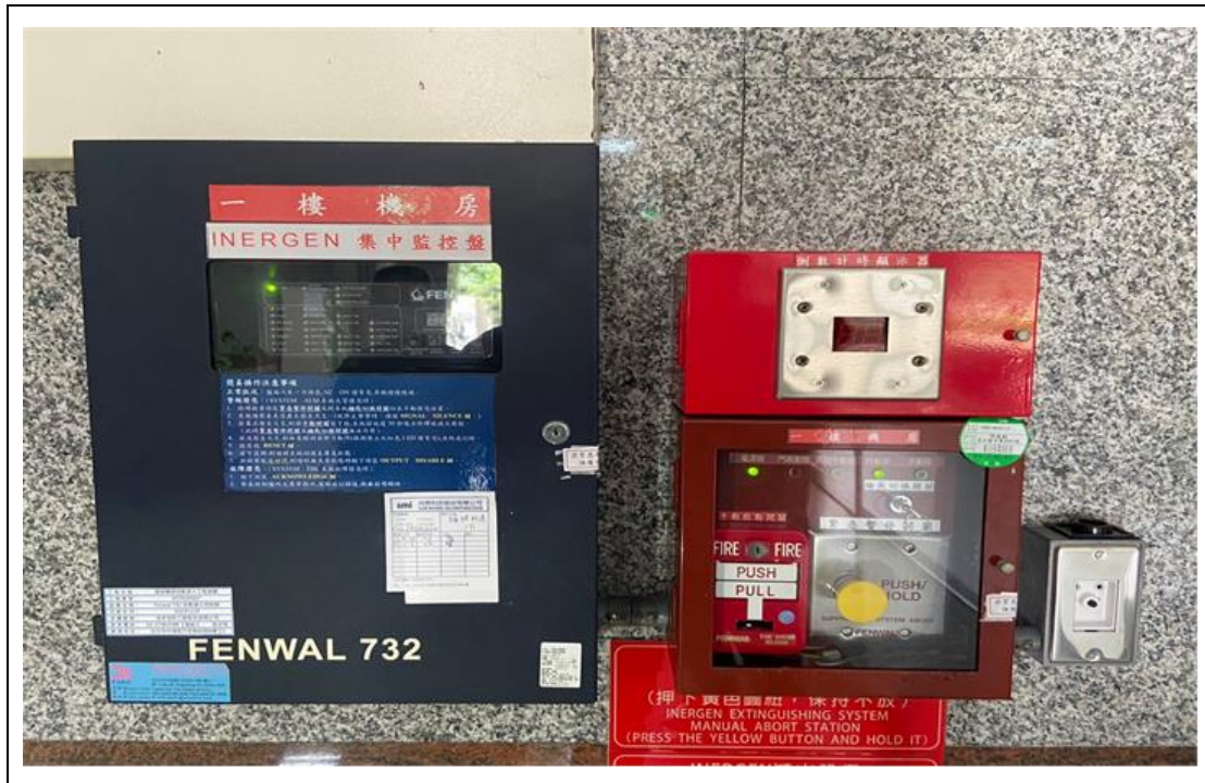
惰性氣體滅火設備啟動裝置(含自動手動切換裝置)
