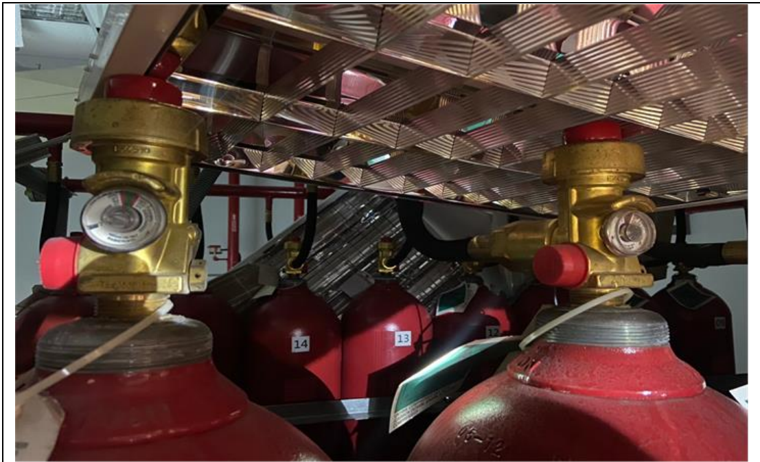
惰性氣體滅火藥劑鋼瓶儲存室誤動作放射之滅火藥劑儲存容器
