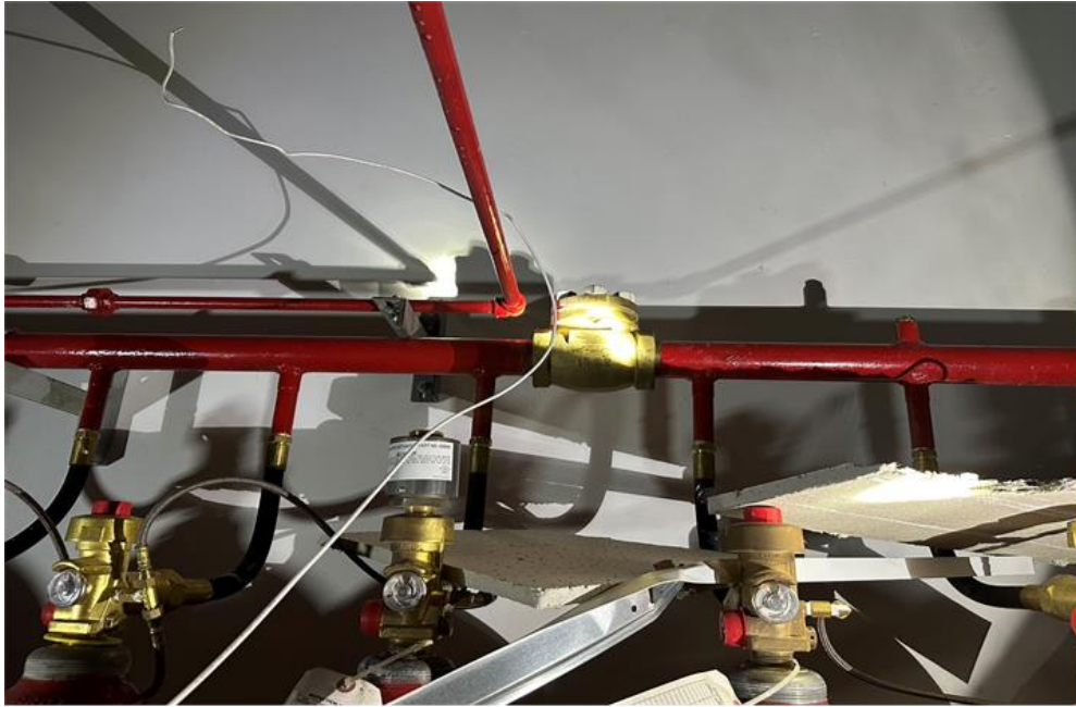
惰性氣體滅火設備操作管及逆止閥
