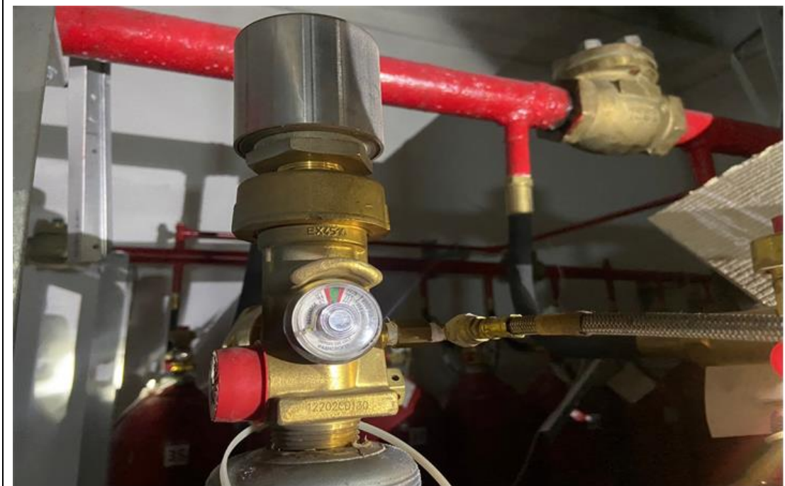
惰性氣體滅火藥劑鋼瓶儲存室誤動作放射之滅火藥劑儲存容器
